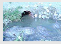
Vertido de aguas fecales directamente al mar.
